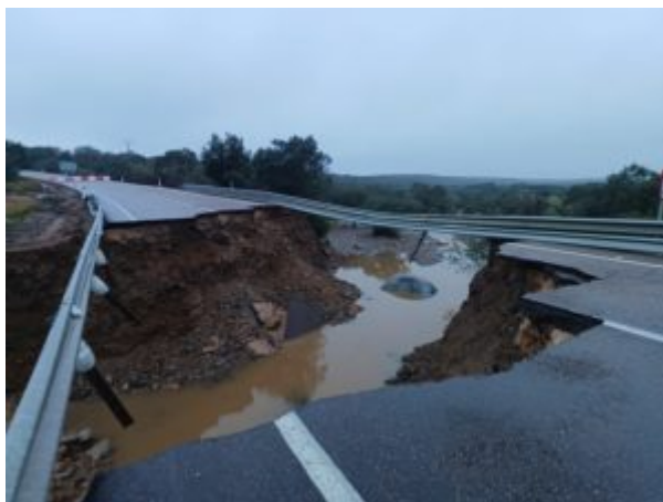
Figura 10. Rotura del asfalto y socavón en la carretera N-523 producido el 13 de diciembre de 2023. Fuente: Fotografía del Archivo de José Pastor Villegas.
