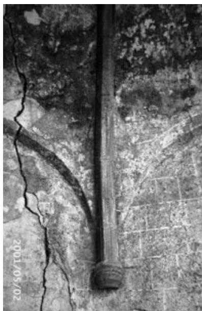
Lám V - Grietas del ábside.
