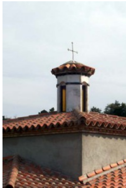
Conservación de la antigua linterna de la ermita sobre la reconstrucción actual.
