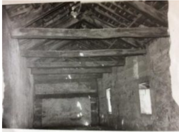
5. Interior de la casa de Sta María antes de la restauración
